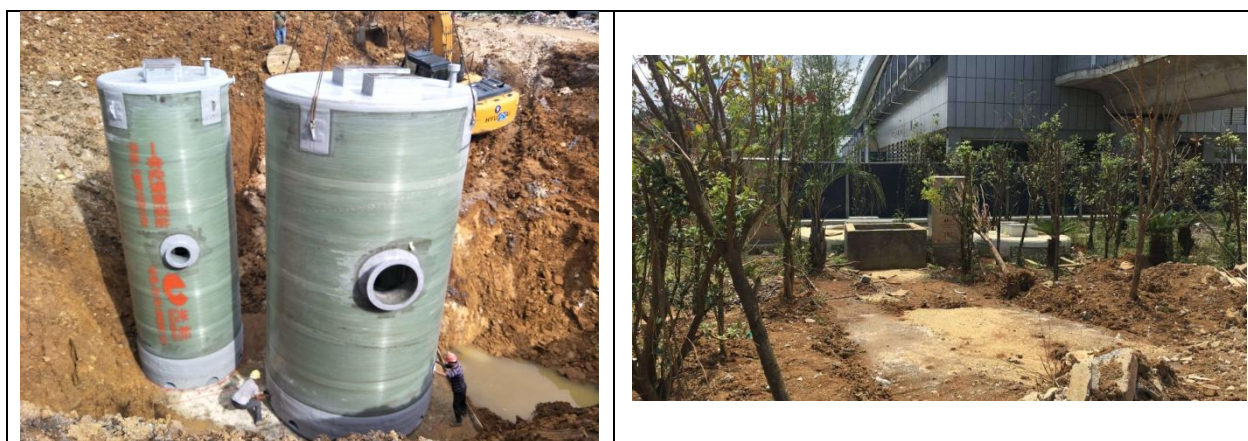
图 8.1-6 老湾塘站生活污水提升设施照片（左侧为施工期）
